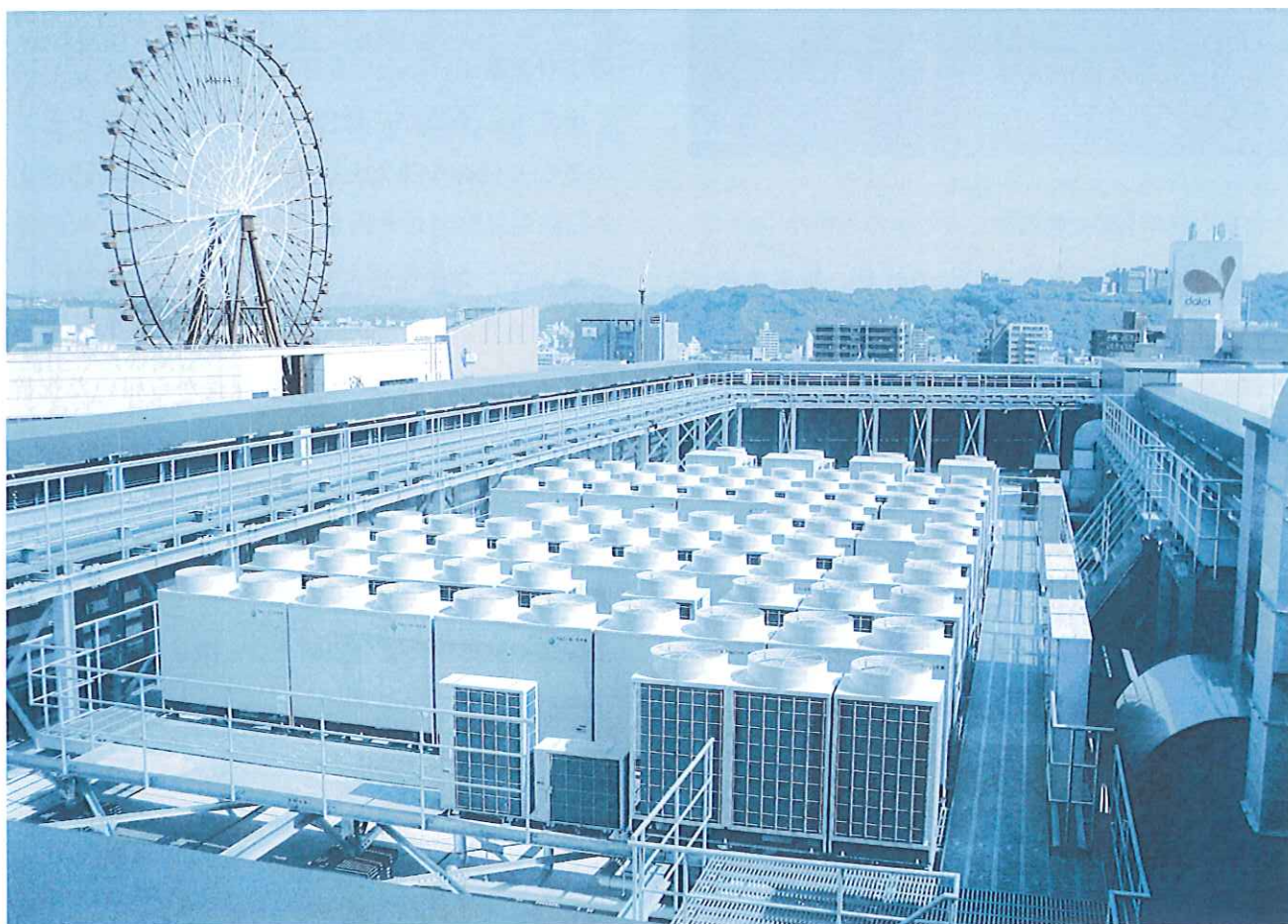
—空調機のある光景（鹿児島市）—
