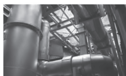
プラント配管
